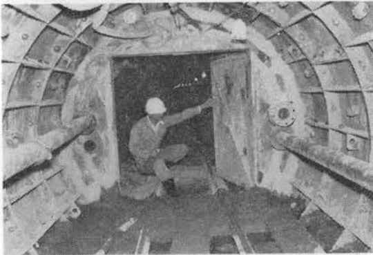
写真-4 エアロック室内
