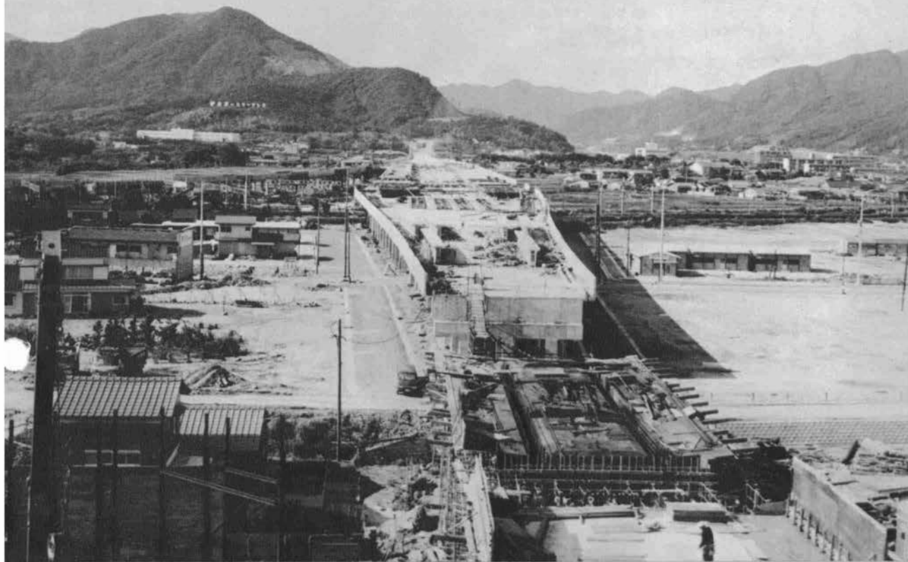
▲新下関（仮称）駅高架橋 中央部で山陽本線長門一の宮駅と交差している。
