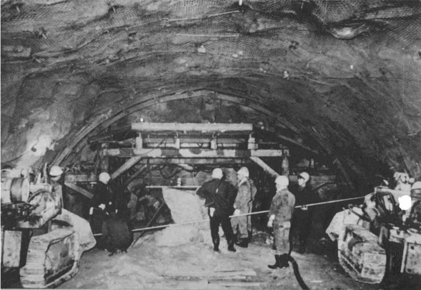
▲福山トンネル東工区上部半断面 切羽付近はH形鋼支保工，手前はロックボルト工
