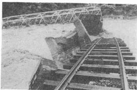
写真-1 災害を受けた第3酒匂川橋梁 (山北方より)
