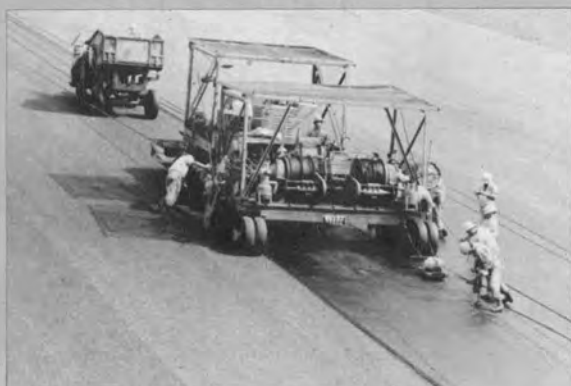
▲斜面部下層の施工 (左よりダンバ車、フィニッ シャ、ウィンチデッキ、車輪の後にジョイント コンパクタおよびタンバが見える)
