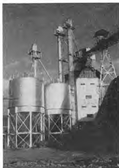
写真-3 パッチャプラント
