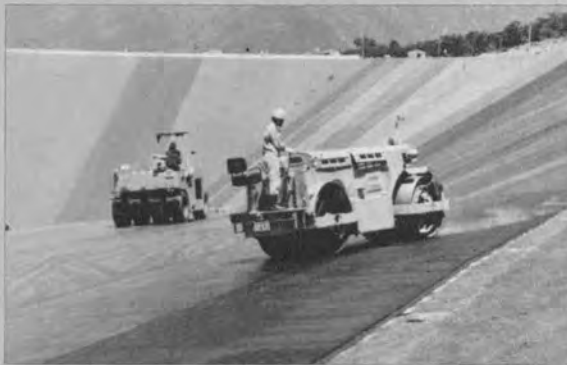
▼底面部密粒層のダンデムローラによる1次転圧とタイヤローラによる2次転圧
