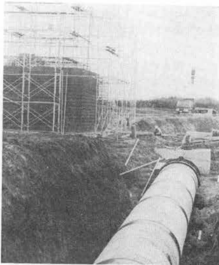
写真—4 コンベンショナルサージタンクおよび本線管路工事
