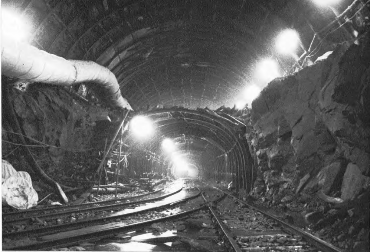
▲大清水トンネル仙の倉工区 (2,750m) 仙の倉斜坑 (662m) 底より本坑を見る
