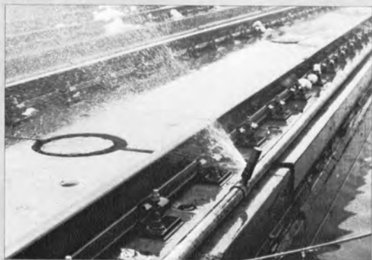
▲散水(温水)方式によるスラブ軌道の消雪 (九日町高架橋上において)
