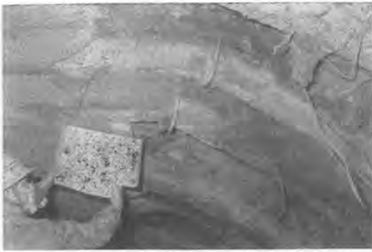
写真-2 支保工座屈状況
