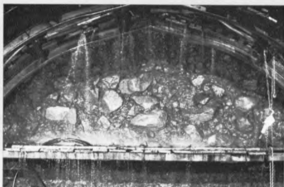
◀ 榛名トンネル御蔭工区 御蔭斜坑 (360 m) 切羽250 m 付近の湧水 (3 m 3 /min)
