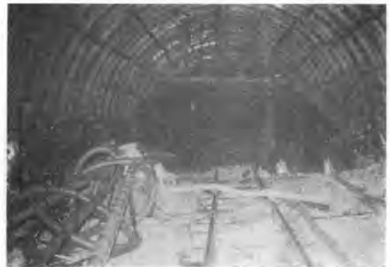
写真—10 斜坑の異常出水（レールの見えなくなる黒い部分が出水状況）
