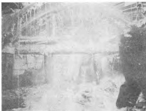
写真-4 白ヶ久保断層での異常出水
