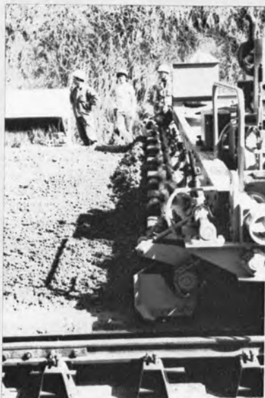
▲コンパクトフィニッシャ前部の ストライクオフスクリードで余 剰コンクリートを切りならす。
