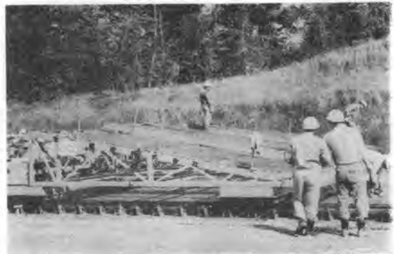
写真-4 メッシュカット（左前方にタイバーインストレーが付いている）
