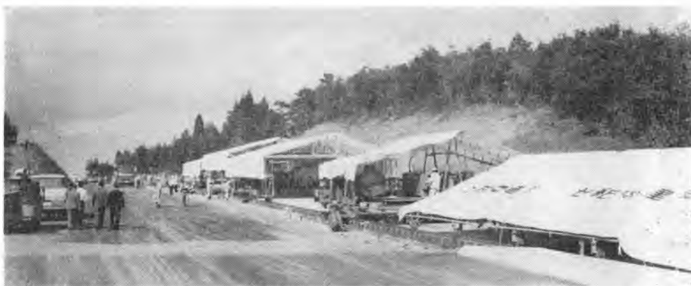
写真-5 大形テント車とそれに続く右方の三角屋根テント車
