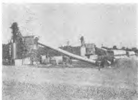
写真-1 1.75 m 3 練りコンクリートプラント (強制練りミキサ付)
