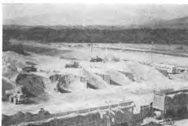
写真-2 コンクリートプラント骨材ストックパイル (手前はビンコンパートメント)
