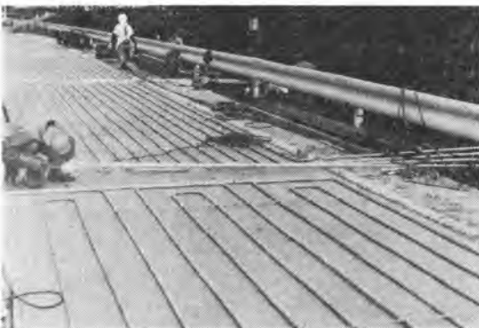
写真-2 鋼管放熱管
