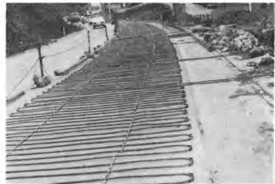
写真-3 銅管放熱管
