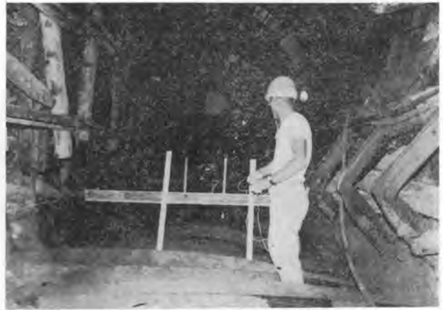
写真-2 導坑支保工の座屈状況
