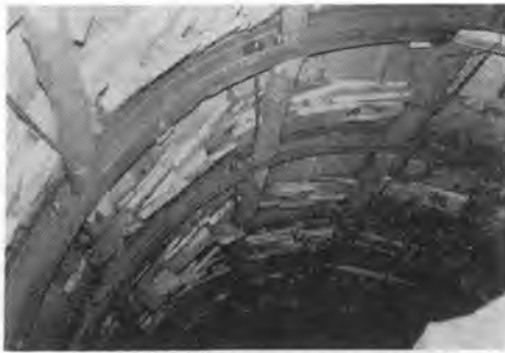
写真-1 矢板の設置状況と矢尻部の破損状況
