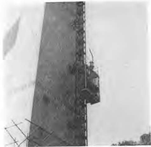
写真-2 高層ビル工事で使用中の人荷兼用エレベータ (SCANDO-1 形)
