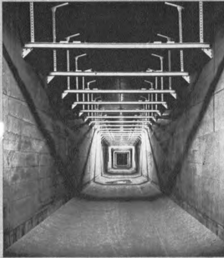
▲エレメント内部の監査部
