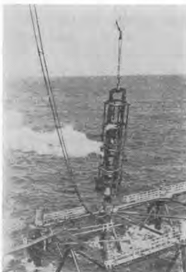
写真-3 MENCK 社のオフショアハンマによるジャケットの鋼管くい打ち作業
