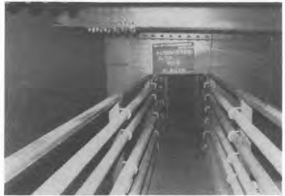
写真-4 検査通路 (電らん管併用)
