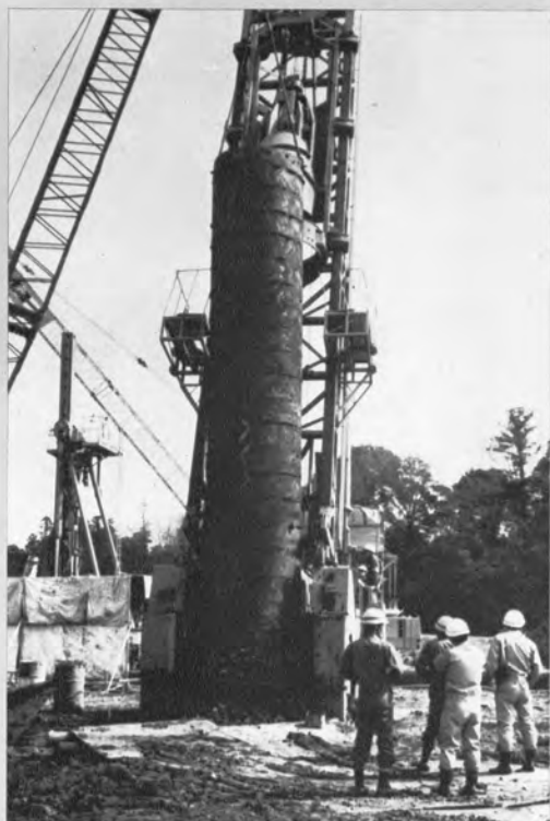
▲ベント工法による場所打ちぐいの ケーシング引抜き作業 —東松山市終末処理場—
