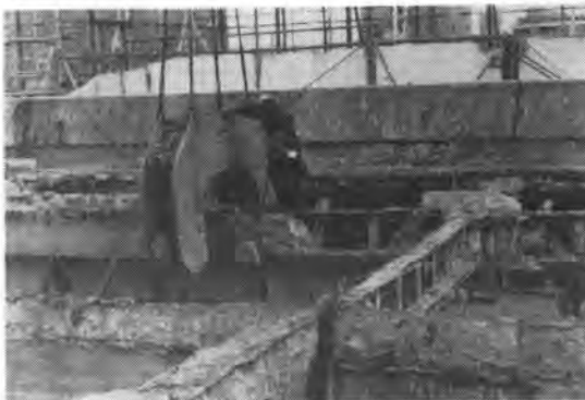
写真-6 福岡朝日会館のはり破壊状況
