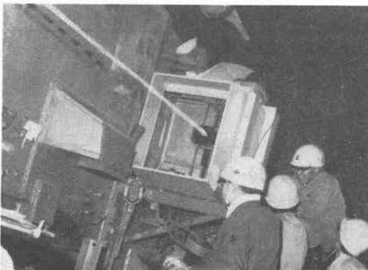
写真-1 検出器の取付状態
