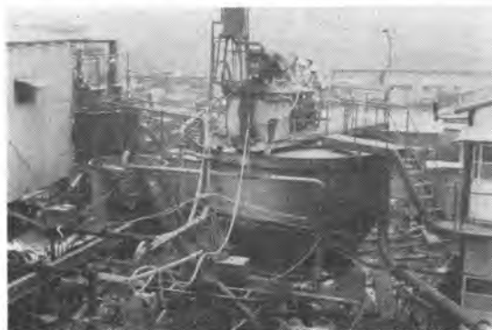
写真-16 泥水シールド土砂分離プラント
