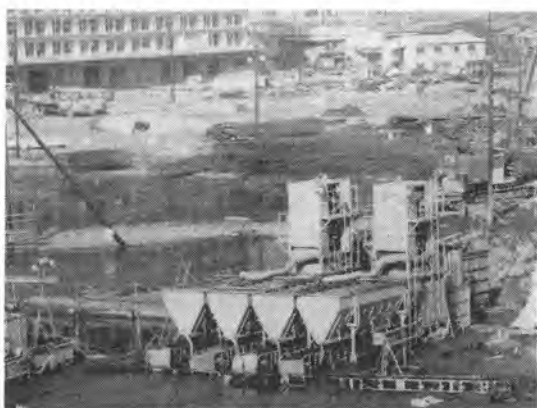
写真-17 アースロック泥水処理装置
