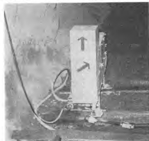
写真-27 ポイント切換装置 (車上操作)
