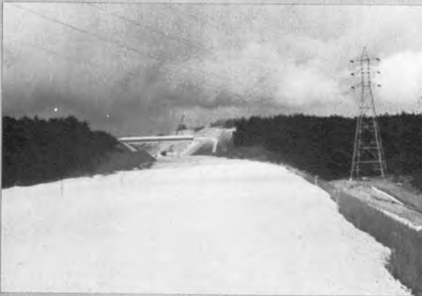
◀ 沖縄のローカルマテリアル・コーラルリー フロック (隆起サンゴ礁で固結度の低い石 灰岩) の上部路床
