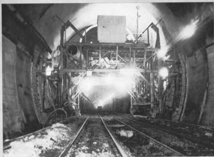
蔵王トンネル石母田工区における 側壁コンクリートの打設状況 ▶
