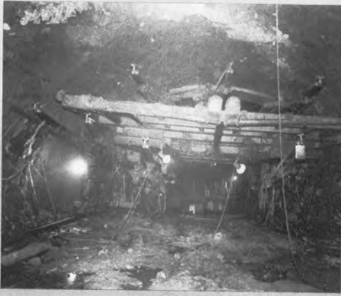
▲一ノ関トンネルの施工状況で、地質にも恵まれ、上半にはロックボルト工法を採用した区間もあった。
