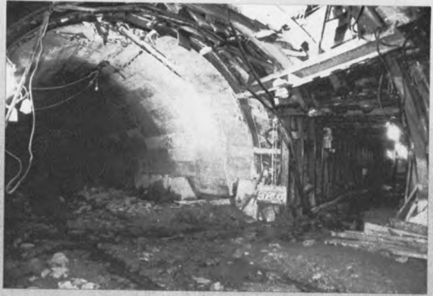
▲蔵王トンネル原工区で、左は埋没し仮巻を施してある導坑、右は迂回坑である。この断層を突破するため当箇所では迂回坑を4本掘削した。
