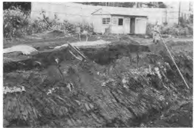
写真-4 円弧すべりを起した未改良土(右端は正常なり面)
