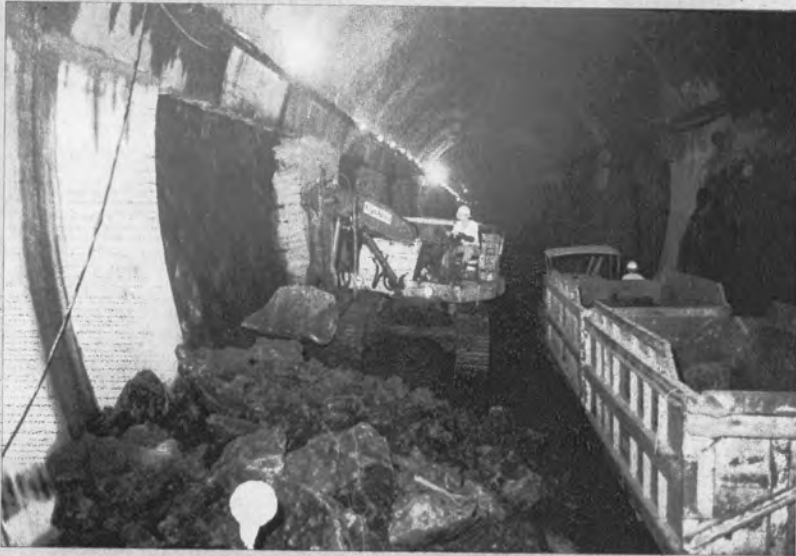
◀蔵王トンネル石母田工区における土平の掘削状況で、当工区は地質も安定しており、順調に作業を進めている。
