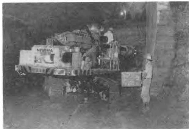
写真-4 第4利府トンネル339 k 020 m付近でのユニヘッダによる下半掘削
