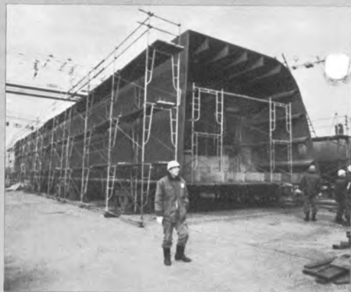
▲ 主ゲートの工場仮組み状況で、下側がスキムプレートである。 (鋼重1門約460 t)
