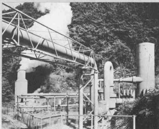
▽ 大岳地熱発電所 (出力 11,000 kW) —九州電力(株)—
