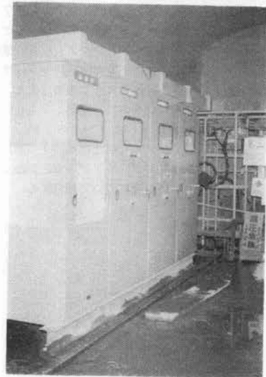
写真-2 無接点式高压電動機盤
