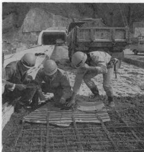
写真-3 ロードヒーティング
