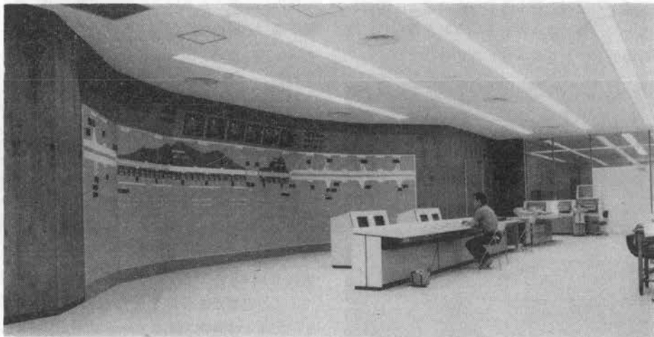
写真-4 コントロールセンター(飯田インターチェンジ)
