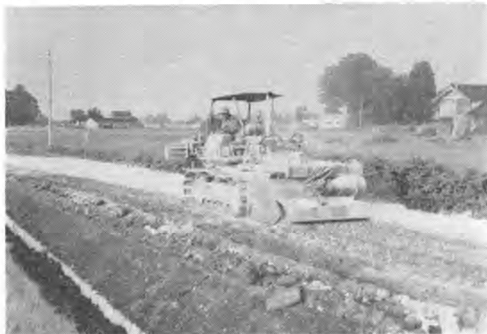
写真一1 ベーススタビライザによる農道路盤の安定処理（処理厚 30 cm）
