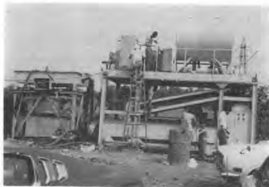
写真-3 汚泥水処理装置
