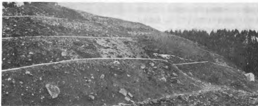
写真-6 Sta. No. 245~246 付近（日光 I.C）の掘削当時の状態（角れき凝灰岩）
