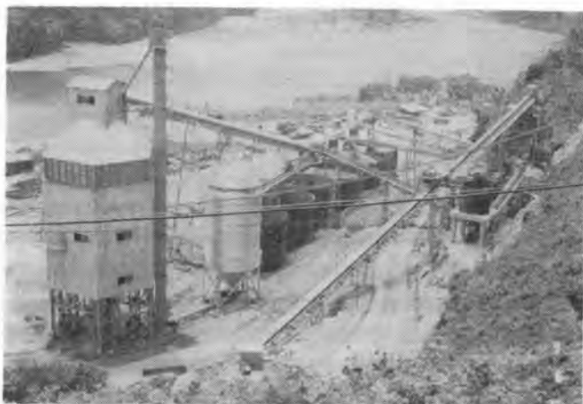
写真-6 プラント全景
