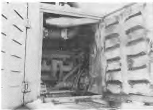
写真-9 防音材の損傷状況
