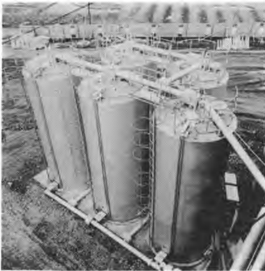
写真7.1-1 電気誘導加熱式アスファルトタンク
