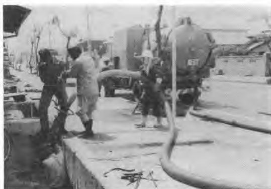
写真-7 側溝清掃車
