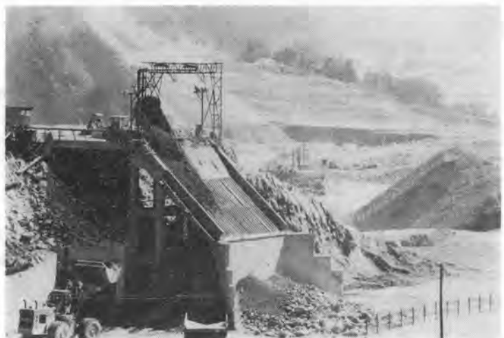
写真-3 グリズリ設備
