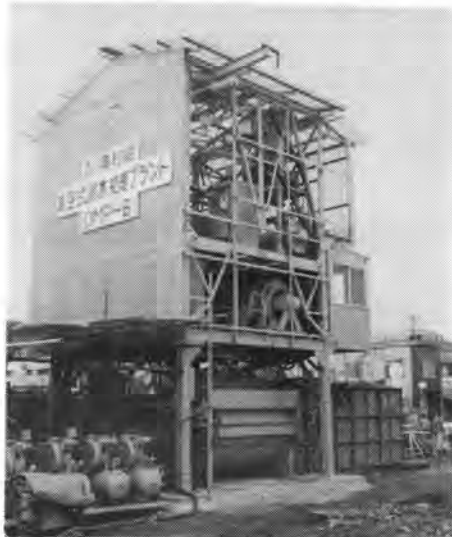
写真-28 市街地用泥水処理プラント
