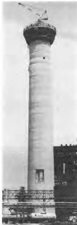
写真-9 フレックスリップ機械により施工中の200 m 超高煙突
