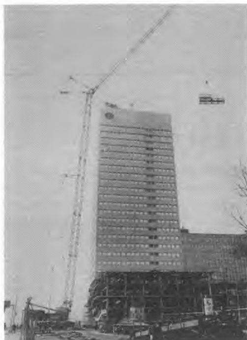
写真-1 TC-1200 型トラッククレーン
