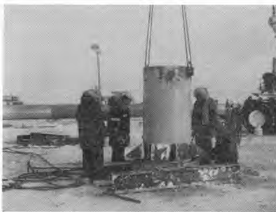
写真-9 ケーシング内にくいをつり込み、スラリー投入のためにくいを固定している
