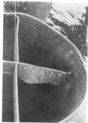
写真-3 鋼管矢板の回転防止板の変形状況
