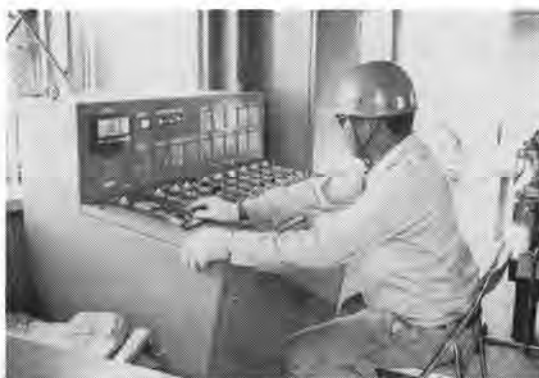
写真-4 運転室と操作盤
