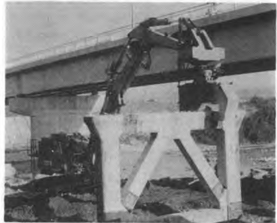
写真-3 コンデストラによる橋脚の破壊状況
