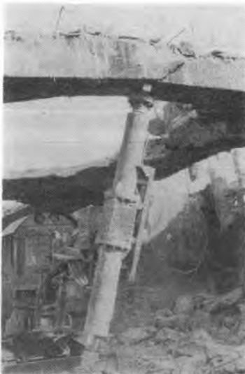
写真-4 アサヒジャッカーによるはりの破壊状況
