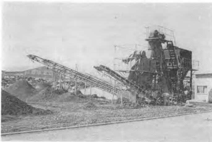
写真-2 プラント本体
