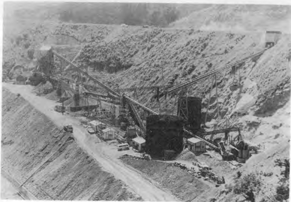
写真-2 コンクリート骨材製造プラント
