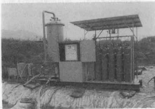
写真-3 炭酸ガス中和装置
