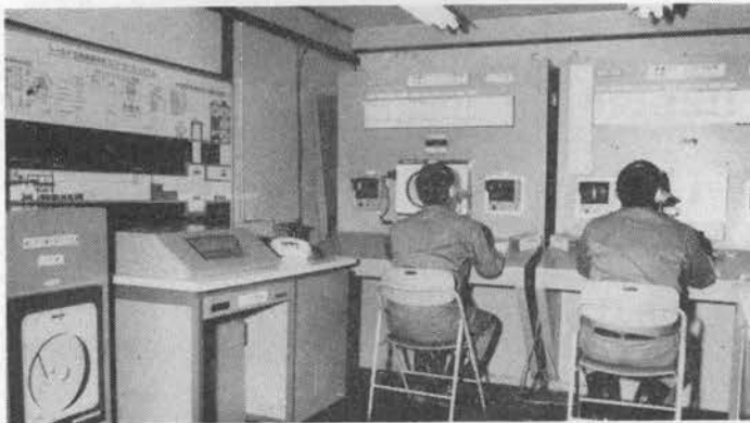
写真-3 中央監視盤およびデータロガー
