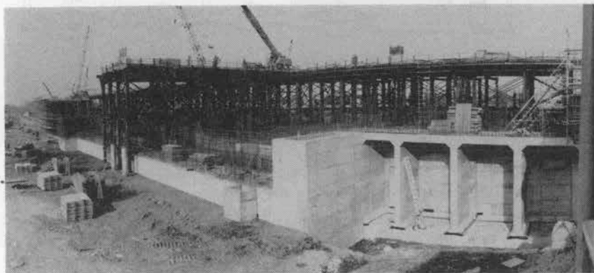
← 写真-4 仮設栈橋設備(施工面積が 広いため各建設資材の搬出 入, コンクリート打設用に 設備する)
