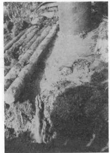
写真-3 泥水の噴出状況
