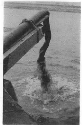
写真-3 濁水状況
