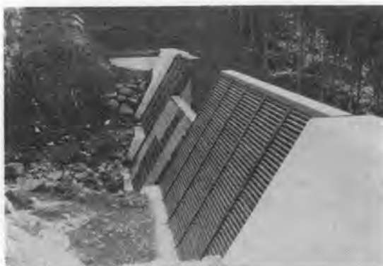
写真-1 鋼製ダム
