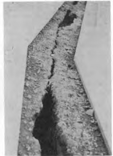
写真-2 クラックの状況
