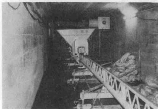
写真—5 工事用モノレール
