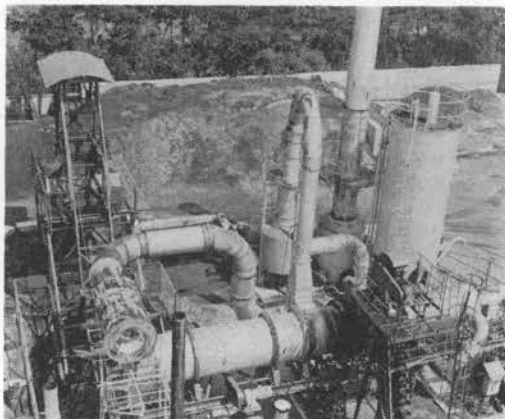
写真-34 アスファルト舗装再生利用プラント
