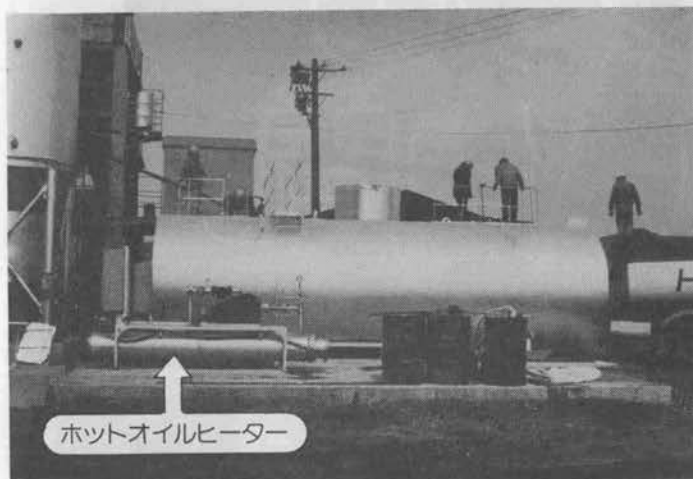
これは60Tonアスファルトプラントにアスファルトタンクヒーターと ホットオイルヒーターを設置した例です。
