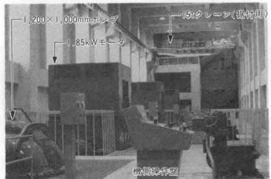
写真-7 房総第1揚水機場内部
