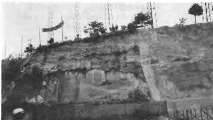
写真-4 宅地造成地近傍の斜面保護工の被害(仙台市)
