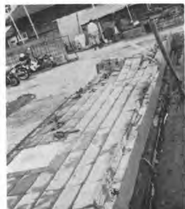
写真-5 ブロック塀の倒壊(仙台市)
