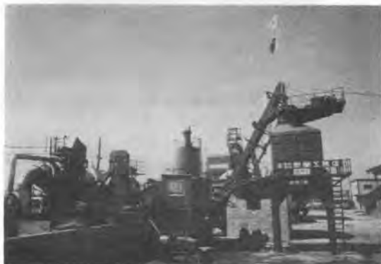
写真-2 リサイクルプラントの一例
