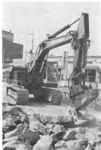
写真—4 → コンクリート破砕機による舗装版の破砕作業 (油谷 400 NIBBLER 型)
