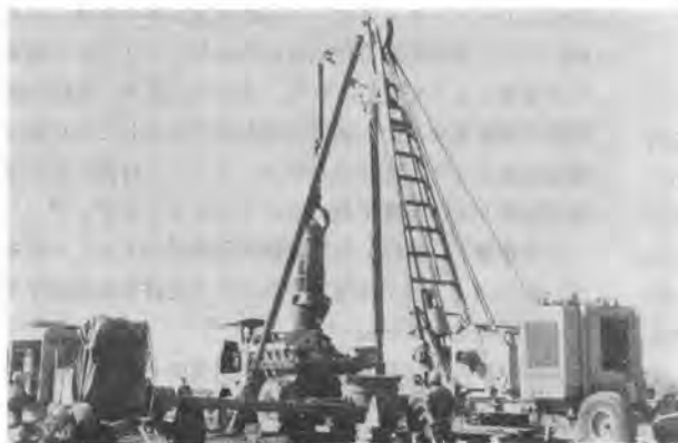
写真-1 川中島犀川橋梁基礎工事のベントNo.6掘削機(昭和30年11月)
