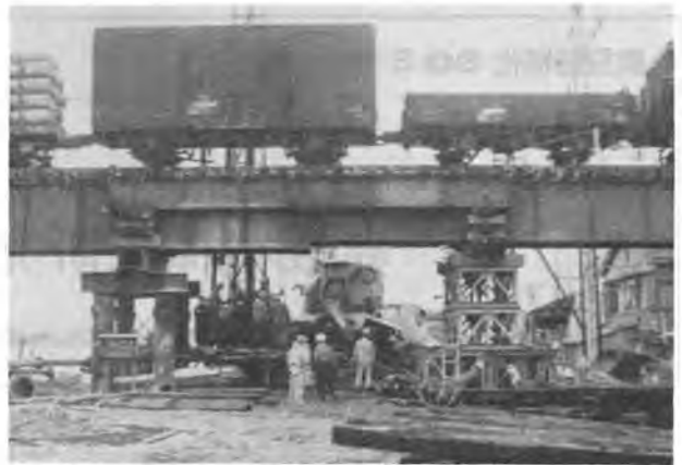
写真-4 新潟地震により被害をうけた信濃川橋梁橋脚アンダーピニング工事のPS150リバース機(昭和39年11月)
