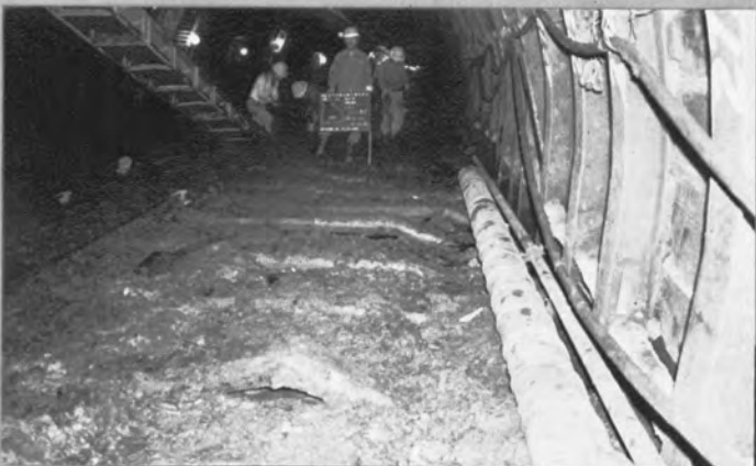
⇨第2工区 No. 18 + 50 m 付近の破碎 帯部における導坑ストラット兼用の 枕木が側圧により破損
