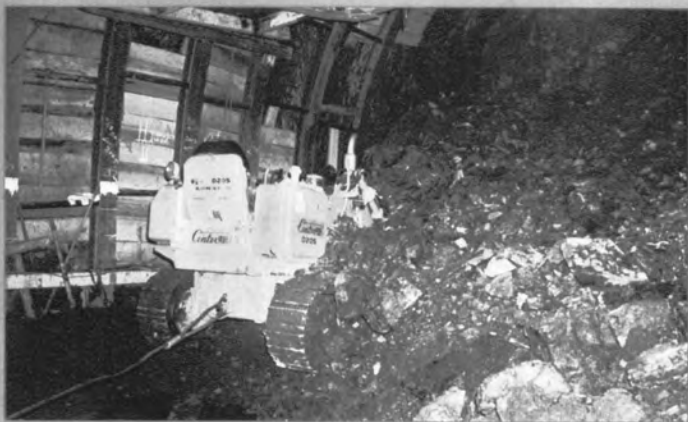
⇨第2斜坑坑口より210 m 付近の神原 谷断層部の切羽崩落状況
