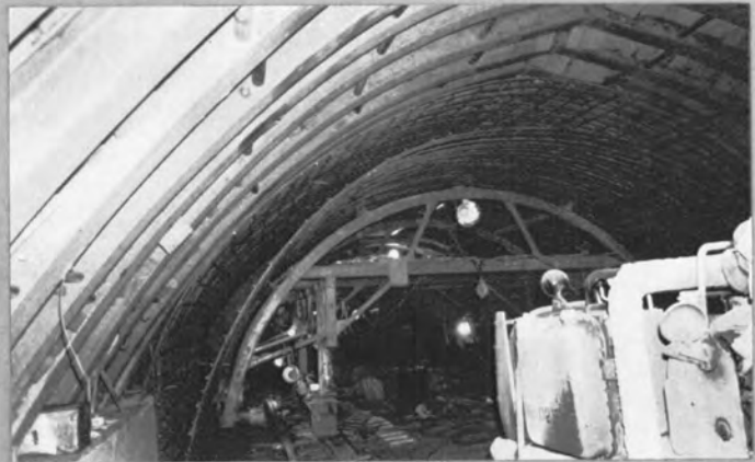
神原谷断層帯悪質部のアーチコンク リート補強用鉄筋組立状況 ⇨
