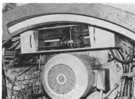
写真-30 シールド機の自動測量装置受光部
