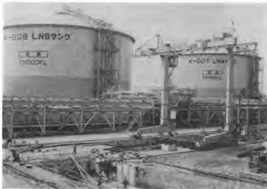
写真-6 円形軌道走行装置付橋型クレーン
