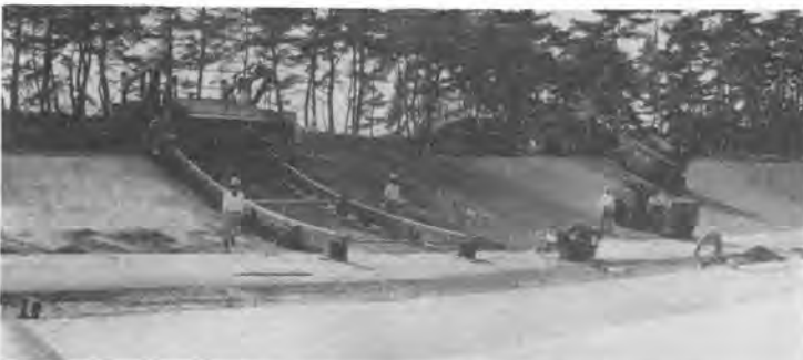
写真-2 高速周回路曲線部のセメント安定処理の新しい施工法
