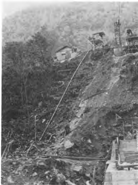
写真-3 配管状況（急な下り配管）
