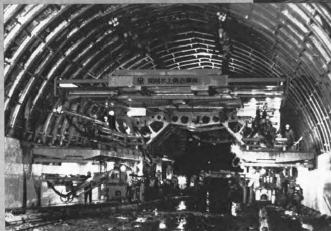
モニター油圧さく岩機8ブーム搭載の 全断面掘削用ガントリージャンボ前面
