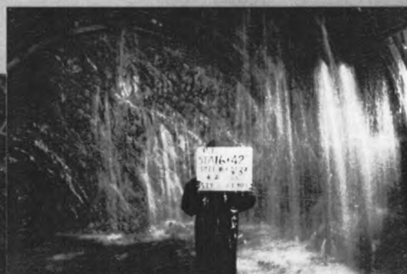
⇨ 800 m 地点の湧水状況 (補助坑)
