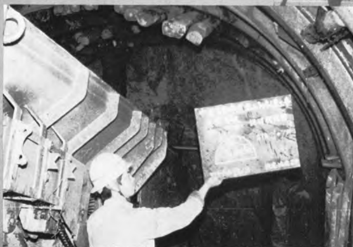
⇨米山トンネル底導切羽における せき矢板状況
