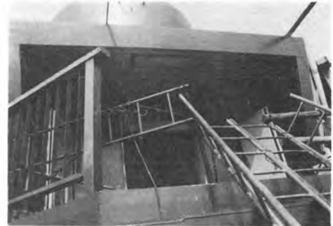
写真-5 → 海中展望室入口 (完成した姿は写真のようにレジンモルタルで塗装する)
