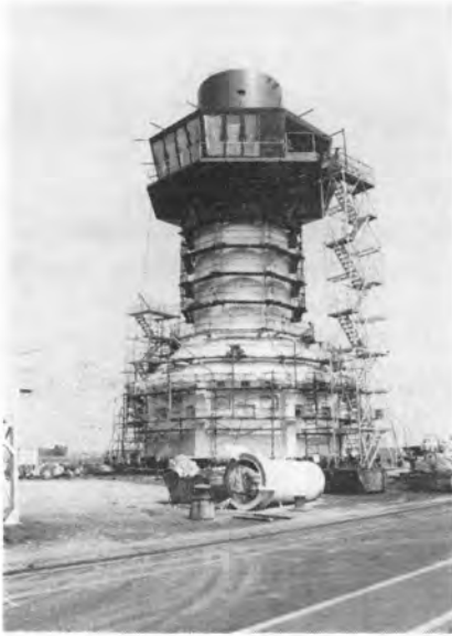
↑ 写真-3 白色のレジンモルタル(6mm厚)吹付中の海中展望塔(海中展望室は八角形、各一辺に3個の海中窓が取付けられている)
