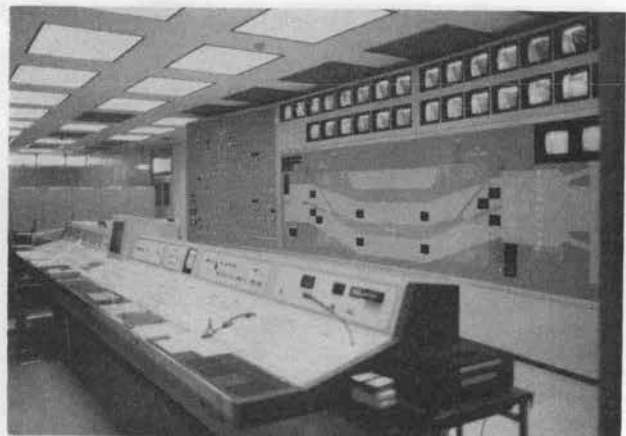
写真-5 中央管制室(グラハネ、操作卓)
