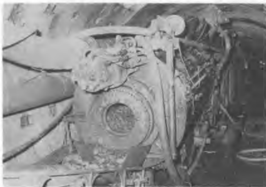
写真-2 れき除去機装置とれきの貯留状況
