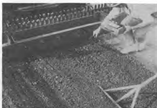
写真一4 ヒータスカリファイヤで加熱、かき起し後の路面 (右上方は路面切削機で切削後の路面)
