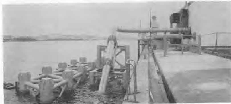
写真-1 ブースタポンプ場(BP 1 )と送泥管
