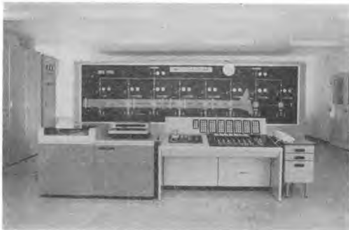
写真-4 中央監視制御室
