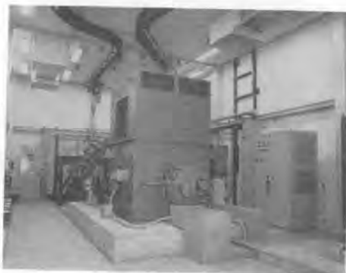
写真-3 ブースタポンプ場
