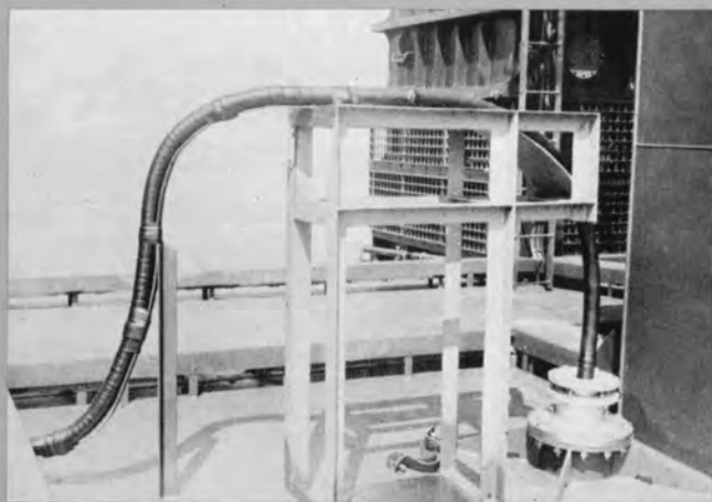
⇨ 「海明」上のケーブル引込部
