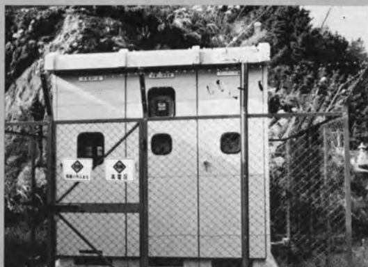
⇨ 白山島における陸上設備
