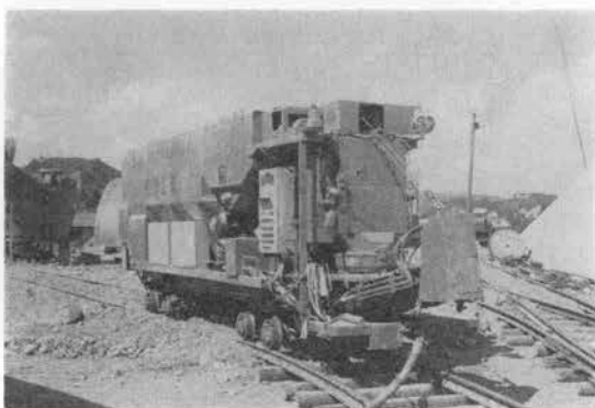
写真—3 吹付コンクリート用連続ミキサ
