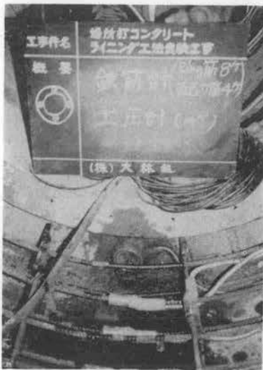
写真-5 計器取付状況
