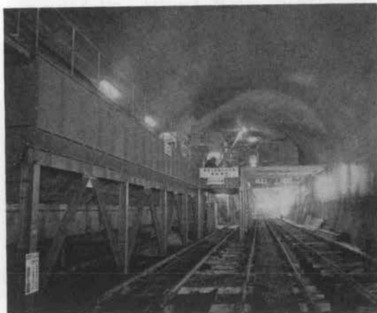
写真-1 坑内コンクリートプラント全景 (セメント貯蔵槽側から見る)
