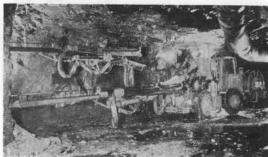
写真一八 全油圧式トンネルジャンボ BOOMER H 132
