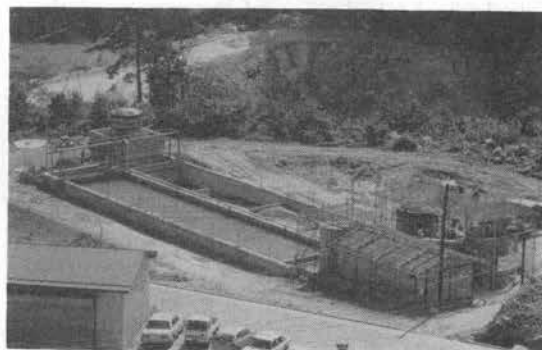
写真-4 ダムサイト中和処理設備 (270 t/hr)
