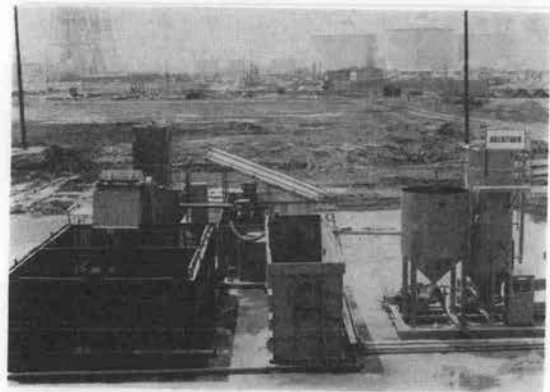
写真-6 安定液処理装置
