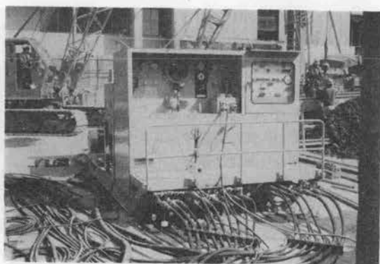
写真-3 油圧ポンプユニット制御装置
