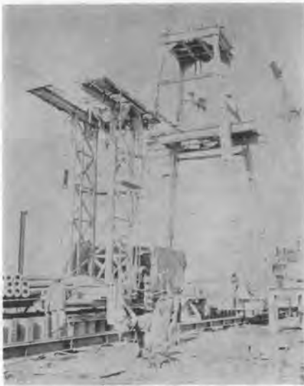
写真-2 鋼管矢板つり込み用やぐら（後方）とリバースやぐらの入替作業
